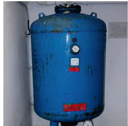
Fig.2: Korrosjon og rust
