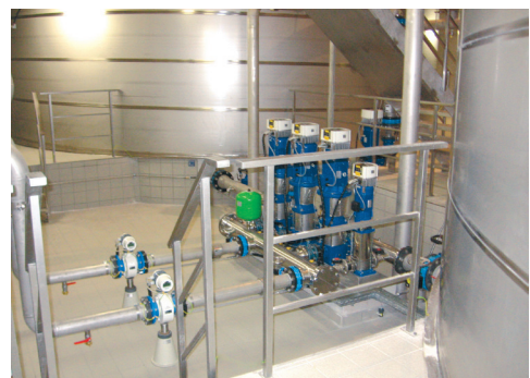
Installasjon med trykkøkingsanlegg
