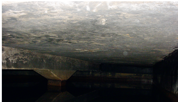
Svært skadet beholder
