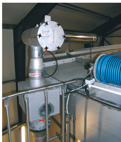
Overløp og luftfilteranlegg
